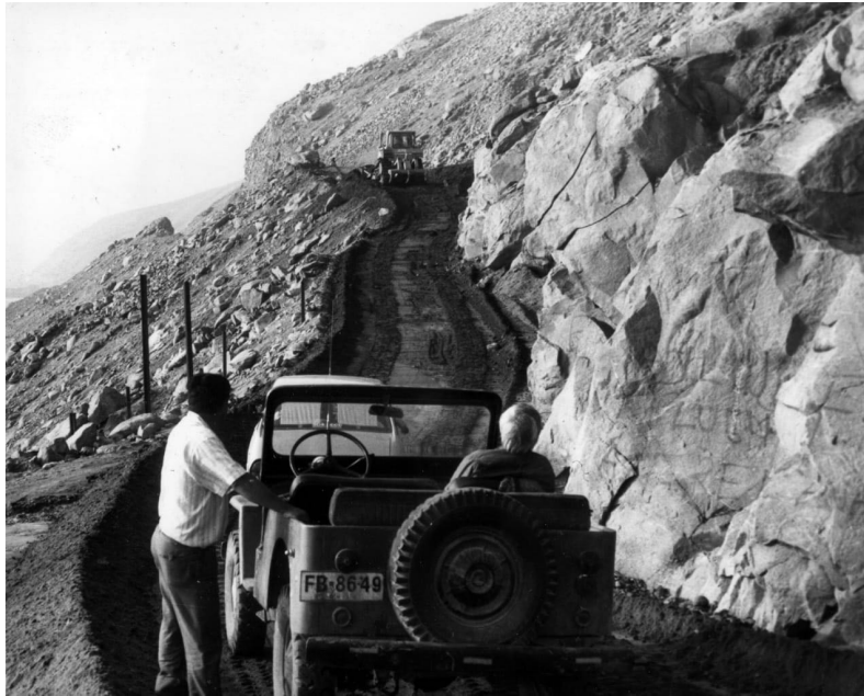
Figura 6: Trabajos de pavimentación del camino costero a cargo de la empresa Besalco S.A. Enero 1994.
